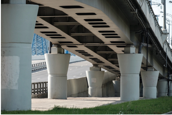
Figura 92. Neoprenos sosteniendo el tablero tipo cajón
